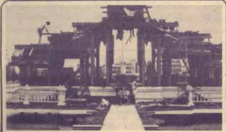
บูรณะ พลับพลากลางน้ำที่มหาวิทยาลัยดำเนินการรื้อถอน เพื่อทำการบูรณะซ่อมแซมให้อยู่ในสภาพที่ดีและเป็นสง่าราศีแก่สถาบัน กำหนดแล้วเสร็จประมาณกลางปี 2529
