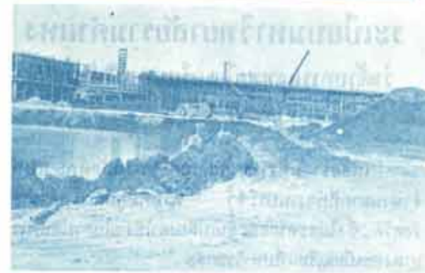
อาคารเรียนชั้นเดียว (NB) อยู่ระหว่างก่อสร้าง
